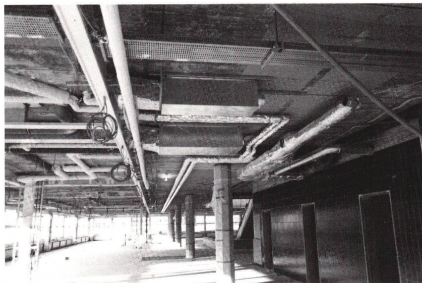
18. Januar 1989: Noch vermittelt ein Blick an die Betondecke des 1. OG einen Eindruck über den komplizierten Verlauf von Sanitär-, Heizungs-, Lüftungs- und Elektrokanälen.
